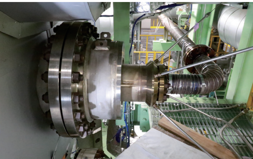
世界最高レベルの温度700度のガスが供給できる配管部分
